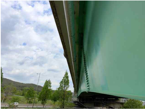
바닥관하면 S3 외측 캔틸레버 상태현황
