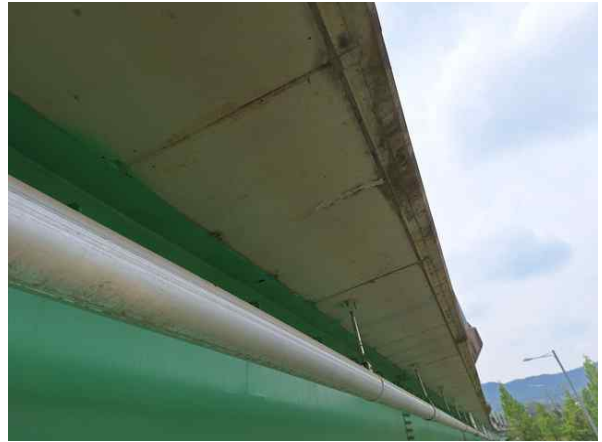
바닥관하면 S6 외측 캔틸레버 상태현황
